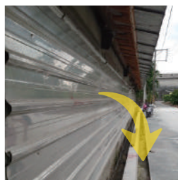
雨水 - 地面設置雨水溝
