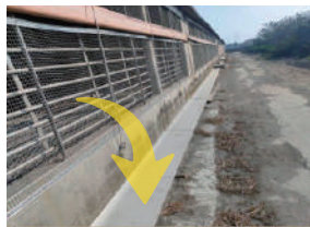
廢水 - 明溝加蓋型態之糞尿溝
